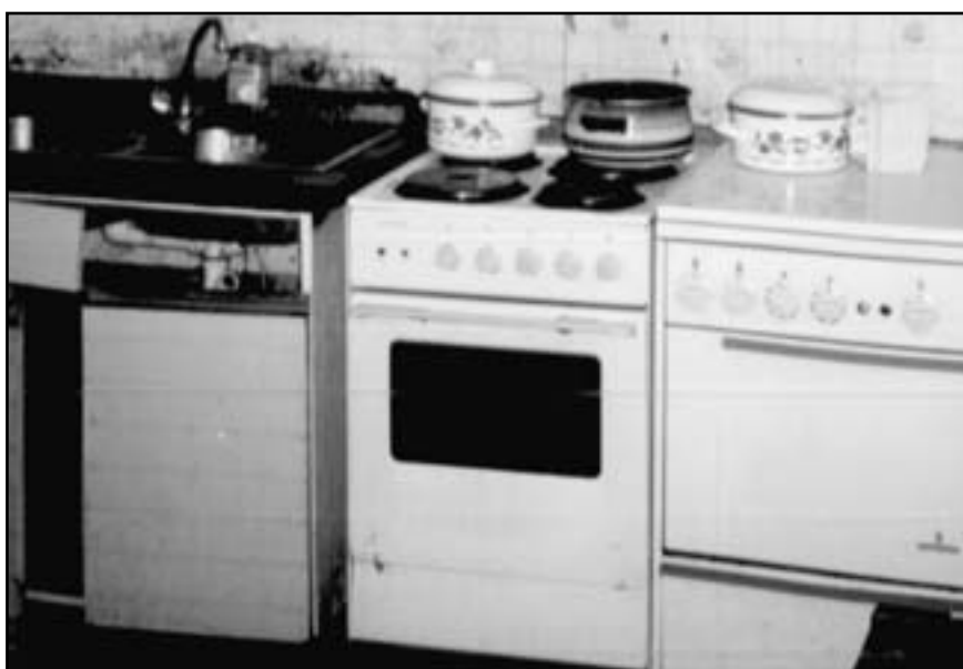
Küche im „Schönhofsblick“, Bad Grund: Schimmel an den Wänden
